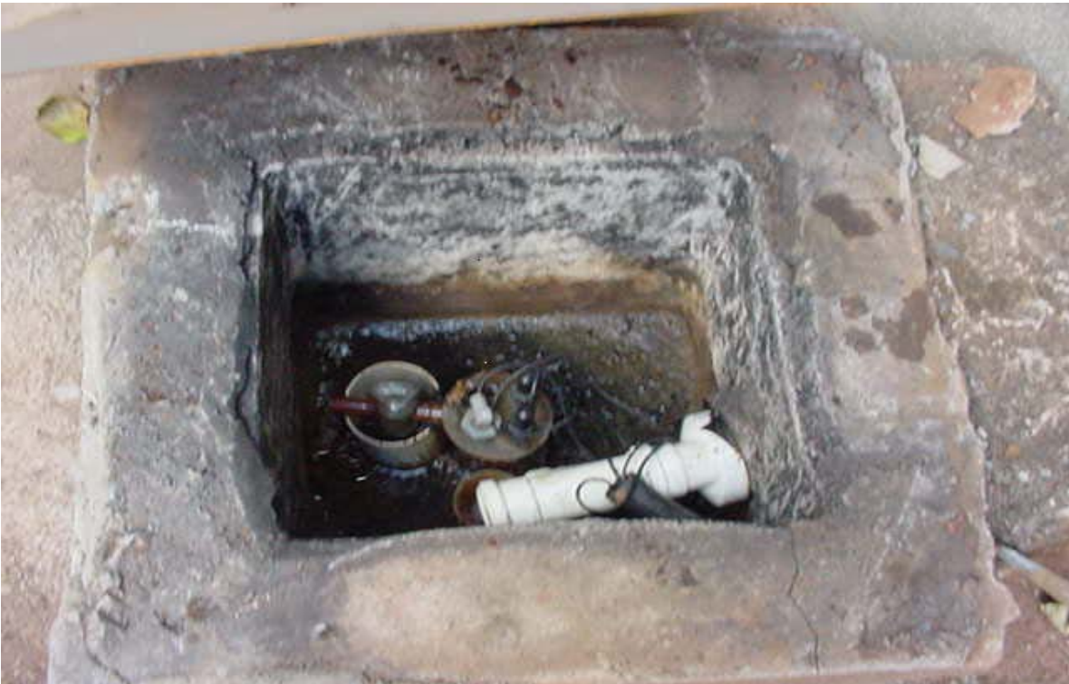
Figura 4.2: foto do dispositivo utilizado na monitoração em contínuo (caixa sifonada dentro da caixa de inspeção dos efluentes de laboratório)
