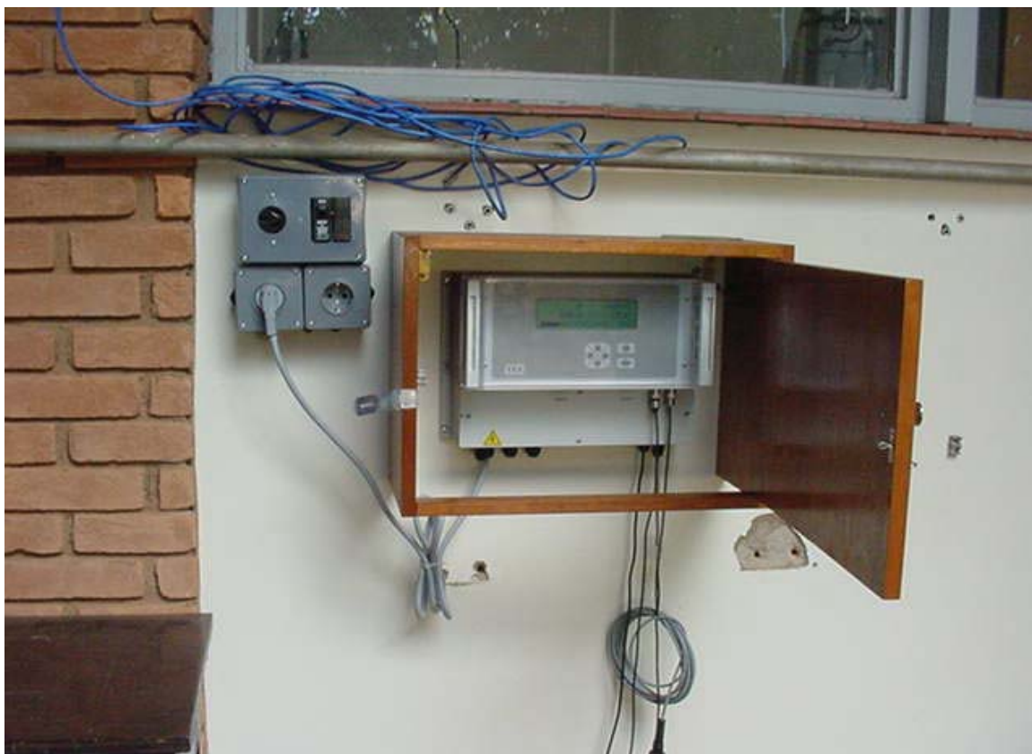
Figura 4.3: foto do equipamento EMEC
