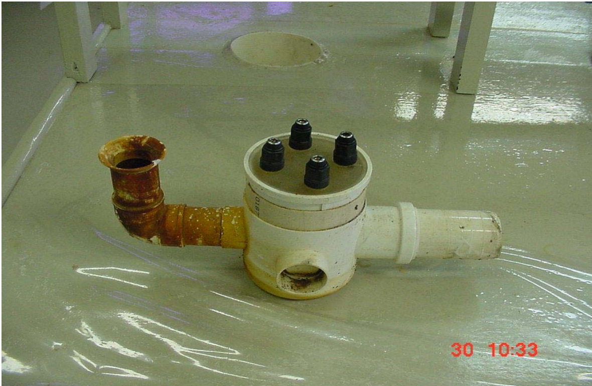
Figura 4.1: foto da caixa sifonada (porta-eletrodos) utilizada na monitoração em contínuo
